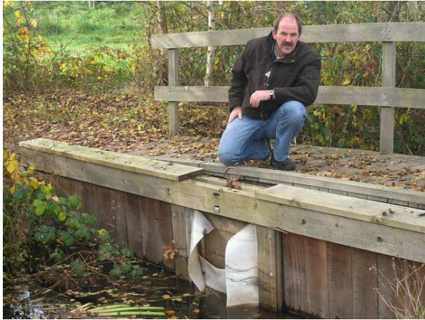
Het sluiten van de schuif
